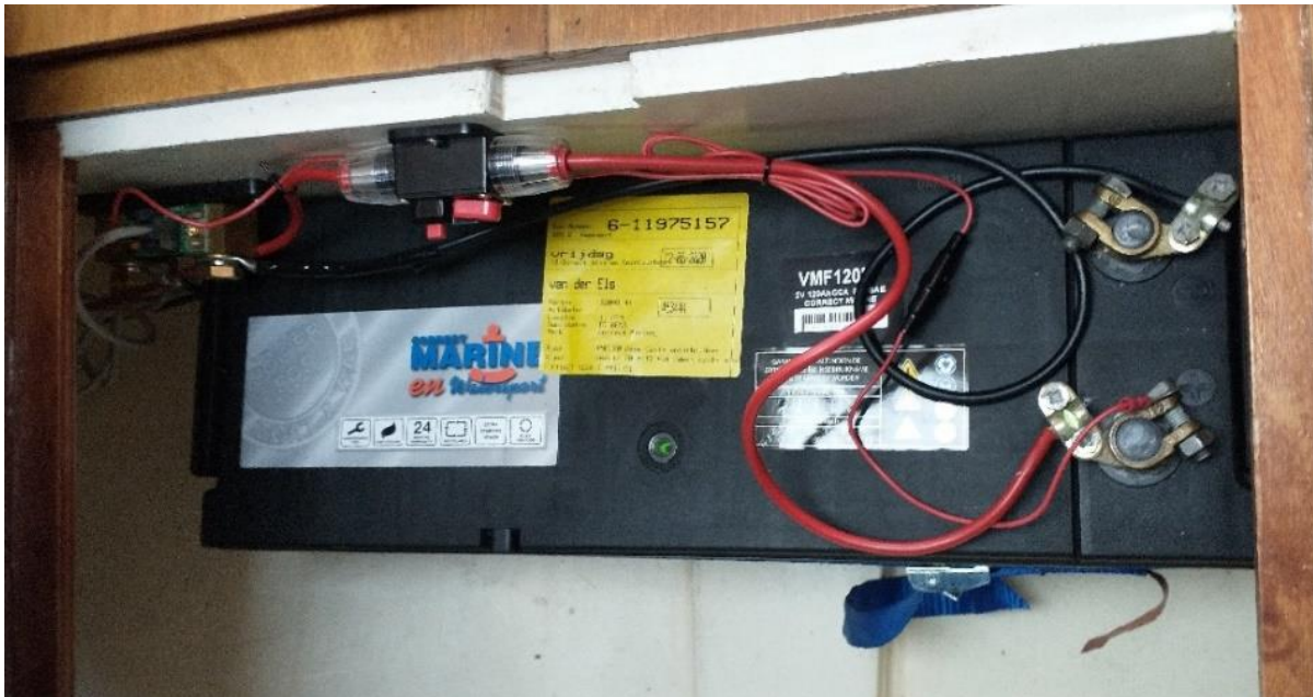
Figuur 12. De nieuwe accu gemonteerd
