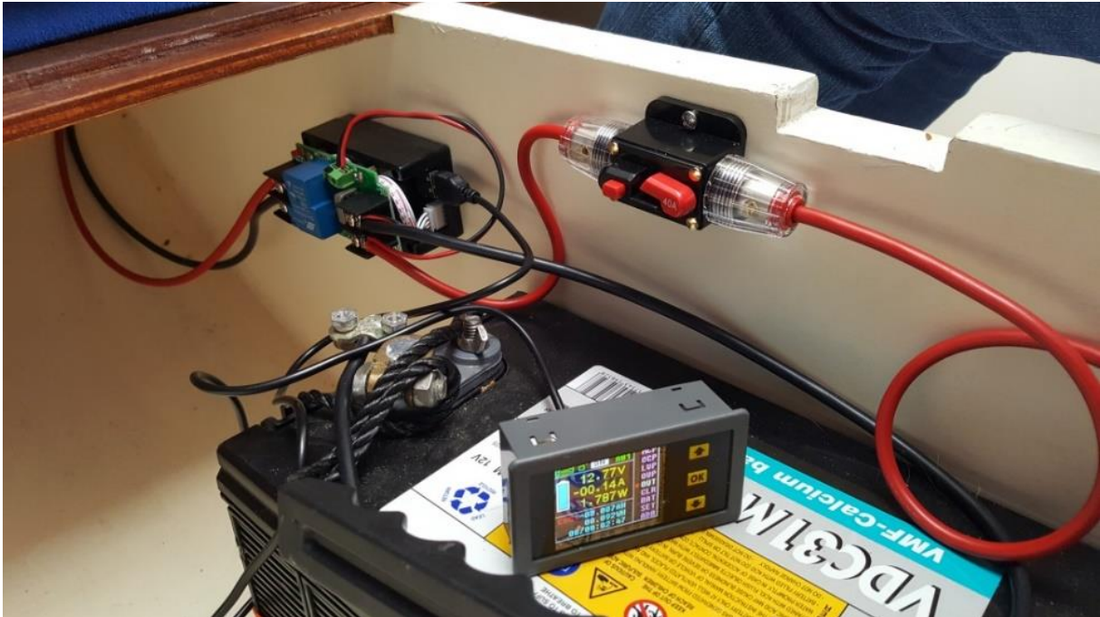
Figuur 4, opnemer en automatische zekering op de accu
